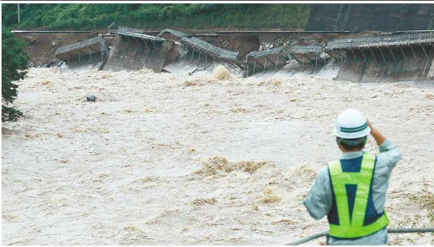
飛騨川の増水で崩壊した国道41号＝8日午後3時6分、岐阜県下呂市小坂町で
