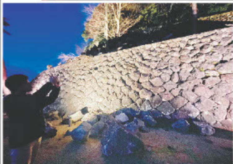
地震で一部が崩れた金沢城の石垣＝1日午後5時26分、金沢市で
